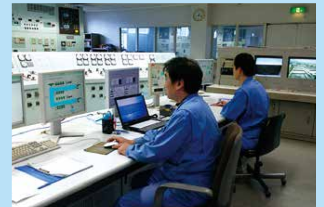
中央監視室の運転状況
